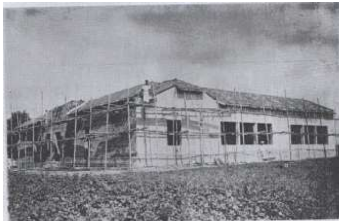
Imagem 1: Pavilhão Central do Instituto Rural Modêlo, em construção na Fazenda Simões Lopes. Fonte: (PARAÍBA, Governo da.1944, p. 213).
