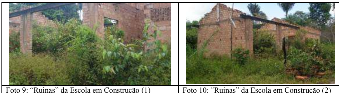
Foto 9: “Ruínas” da Escola em Construção (1)
