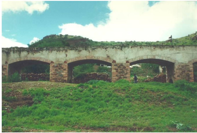
Figura 6. Acueducto de Piedra y Mampostería en “El Hércules”, Querétaro. (ca. 1850) Tipología común de acueductos del siglo XIX en Haciendas y Fábricas. Foto de Daniel Valencia Cruz.
