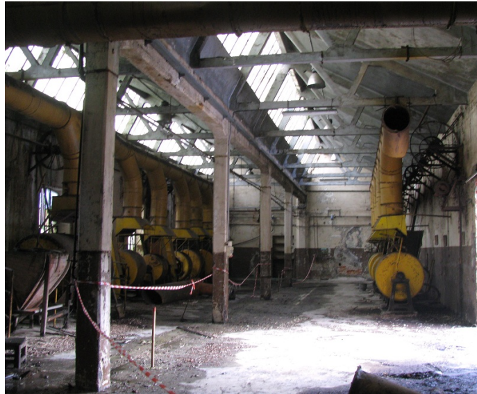
Figura 6. Ciriè (Torino), IpCA. L'interno del padiglione per la lavorazione dei coloranti che, dopo il restauro, verrà adibito a museo della memoria.
