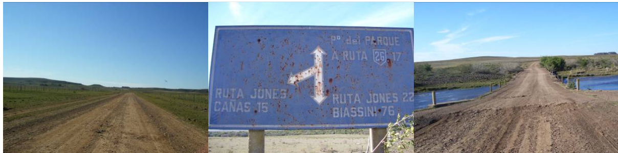
Figura 4. El camino de tosca se pierde en el horizonte, calzadas y cartelería sin mantenimiento.
