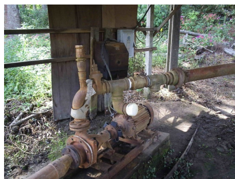
b – conjunto motor-bomba.
