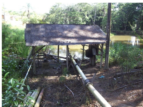
a – Linha de recalque.
