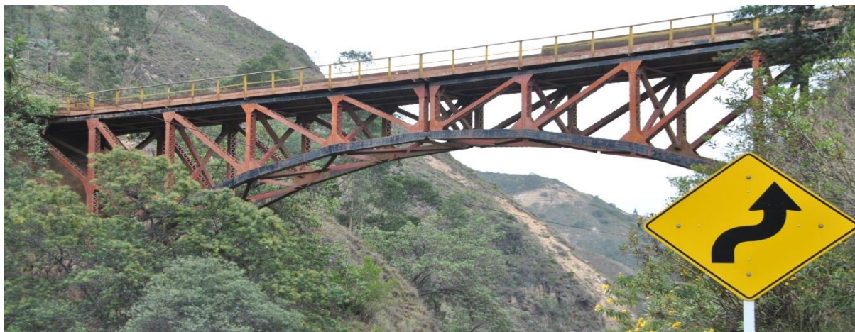
Figura 6. Puente sobre el rio Salguera que une la mina de hierro y la administración. Fuente: Armando Muñoz Luque.
