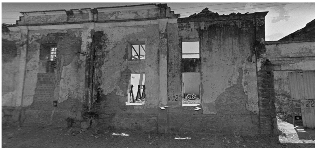
Figura 11. Conjunto Porto das Barcas e galpões portuários – ruínas. Fonte: Google Street View, 2018.
