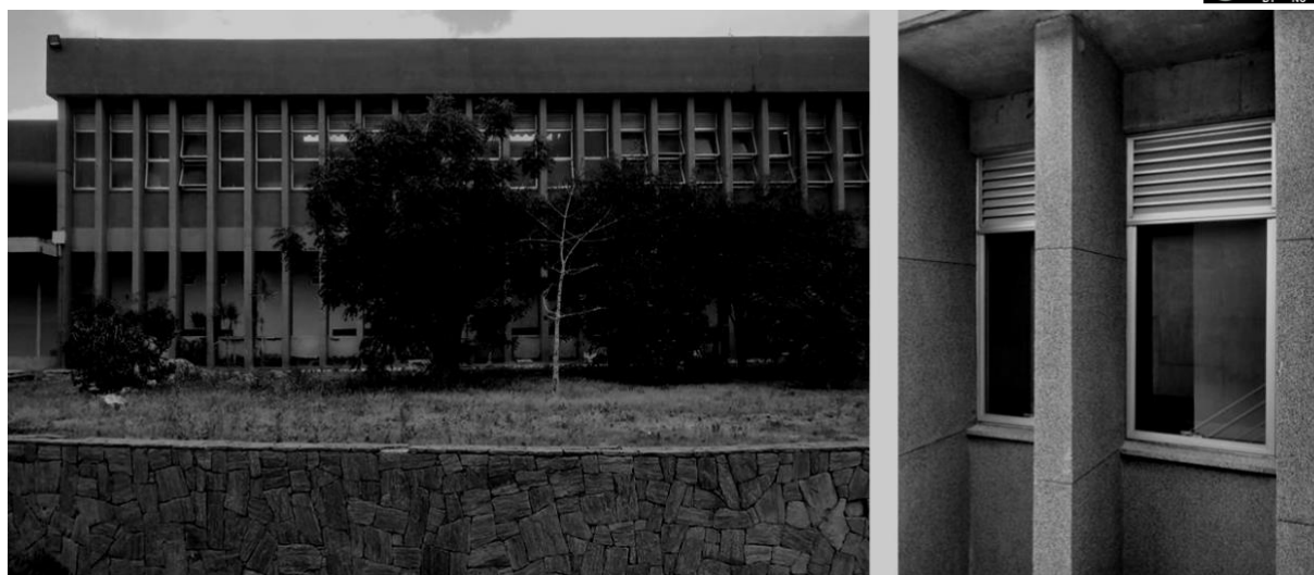
Figura 11. Planos de brises (concreto) e esquadrias (alumínio e vidro) que compõem as fachadas principais dos edifícios. Fotografia: Ivanilson Pereira (2019).
