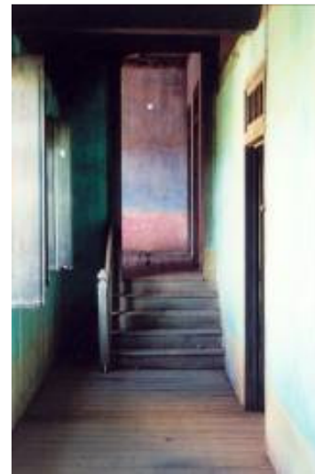
Figura 18. Interior do sobrado, primeiro pavimento: desnível no corredor entre área de serviços e sala de jantar. Foto: Benincasa, 2003.
