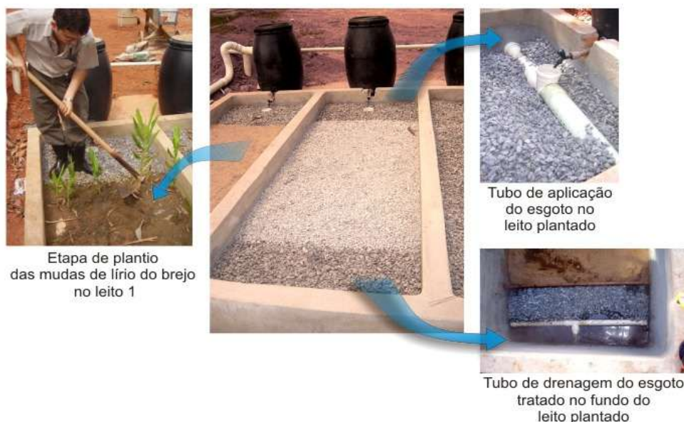
Figura 3 Detalhe executivo do tubo de aplicação de esgoto, do dreno de esgoto tratado e da etapa de plantio dos leitos das zonas de raízes
