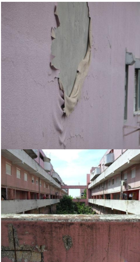
FIGURA 6 - Bairro dos Lóios: Pantera Cor-de-rosa; Patologias da Construção. (Fotografias dos autores).
