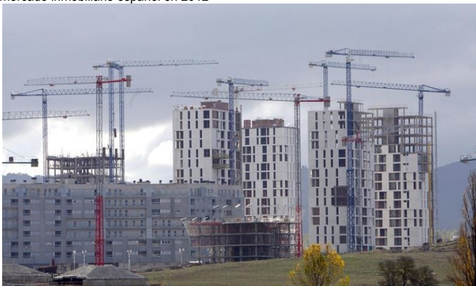
Figura 1 - Viviendas sin terminar en un PAU de Madrid, imagen del estancamiento del mercado inmobiliario español en 2012
