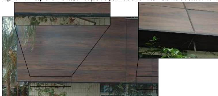
Figura 12 - Desprendimento, oxidação do perfil de arremate metálico e destacamento do delimitador de profundidade
