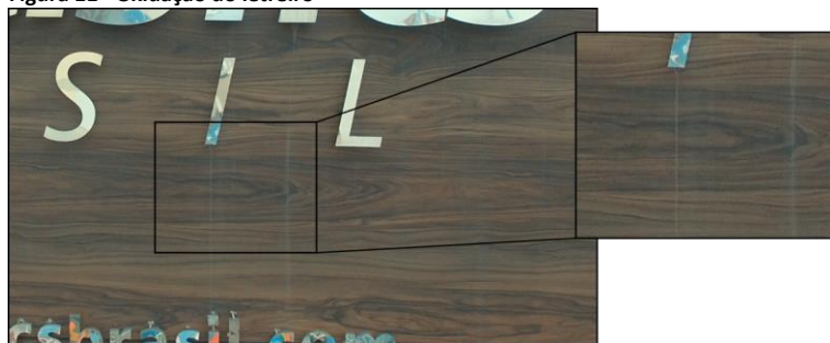
Figura 11 - Oxidação do letreiro
