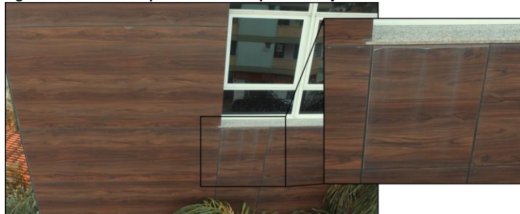
Figura 9 - Manchas nos painéis abaixo do peitoril das janelas
