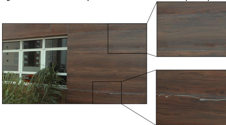
Figura 10 - Manchas brancas no plano de fachada e descolamento da película protetora
