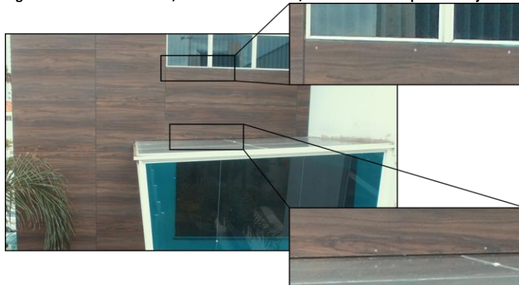
Figura 18 - Rebites amostra, ausência de selante, escoamento no peitoril da janela
