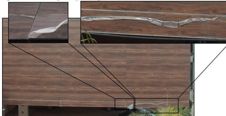
Figura 15 - Delaminação da película protetora e destacamento do arremate metálico
