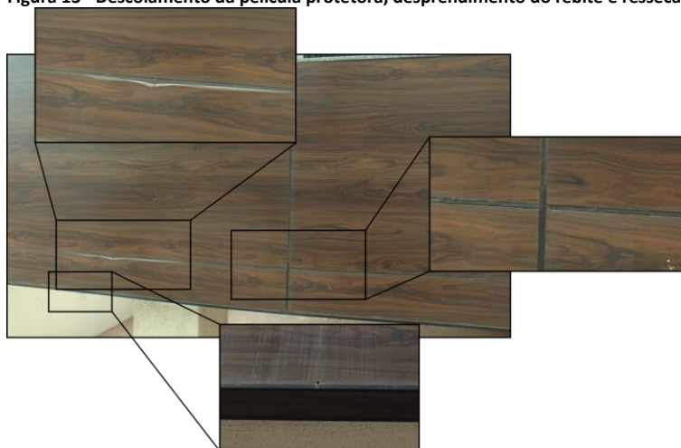
Figura 13 - Descolamento da película protetora, desprendimento do rebite e ressecamento das juntas
