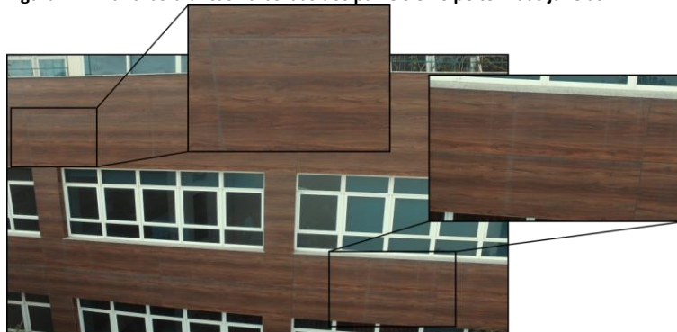
Figura 14 - Manchas brancas na bordas dos painéis e no peitoril das janelas
