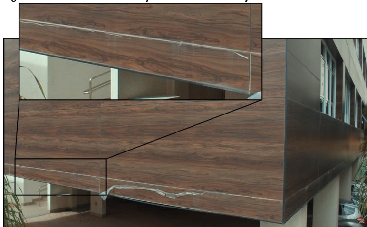
Figura 16 - Manchas brancas nas juntas e acúmulo de sujidades na borda inferior do plano da fachada Oeste
