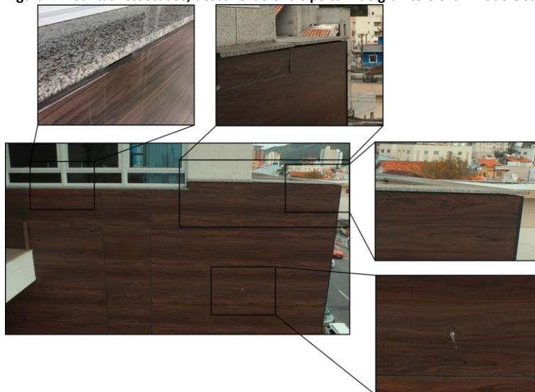
Figura 17 - Juntas ressecadas, desconexão entre peitoril de granito e o laminado e sujidades decorrentes de fezes de aves
