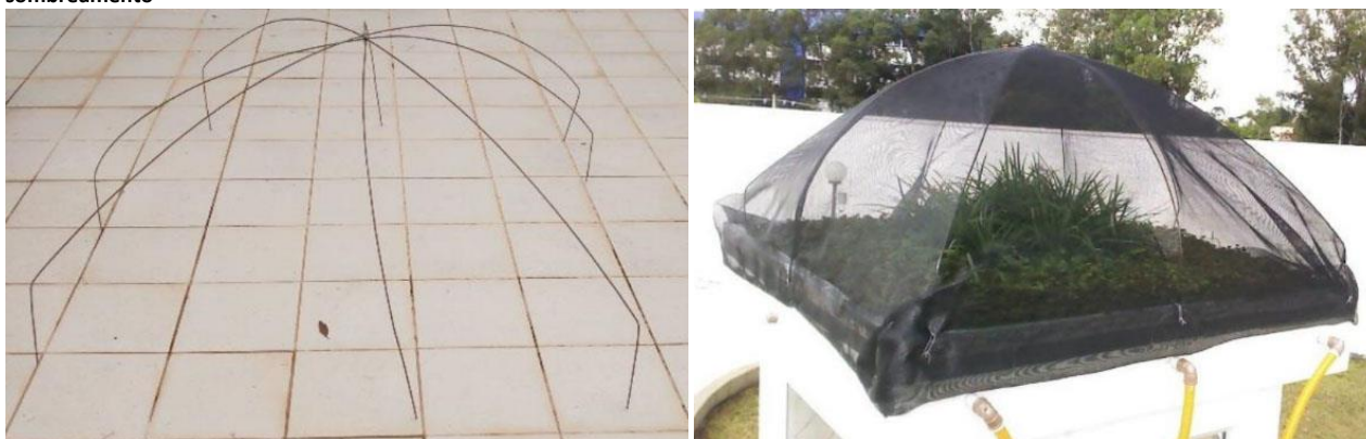
Figura 6 – Implantação de tela de sombreamento sobre a cobertura vegetada: (a esquerda) Estrutura em ferro e (a direita) Estrutura com tela de sombreamento
