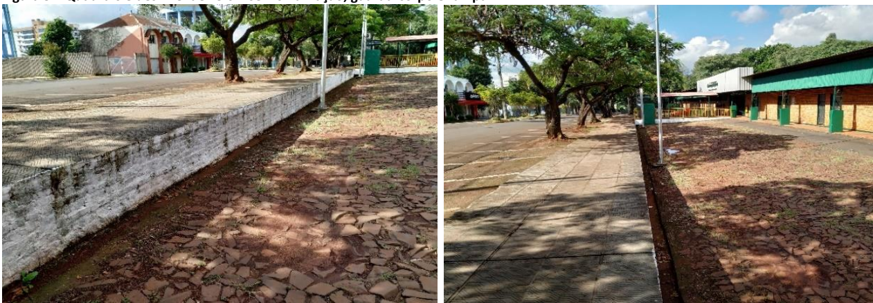
Figura 5 – Quadra 6 e desnível de 75 cm sem sinalização, guarda-corpo e rampa
