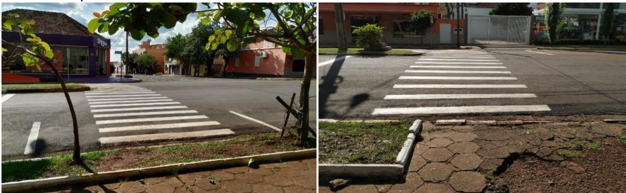
Figura 4 – Quadra 4 e condições das travessias de pedestres, embora haja a faixa de segurança, suas cabeceiras são interrompidas e não há sinais sonoros ou táteis para deficientes visuais
