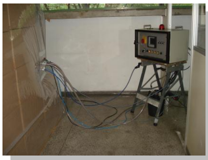
Figura 4- Unidade microprocessada de controle e monitoramento e o canto da bolha com as passagens de cabos e tubos de gás 8
