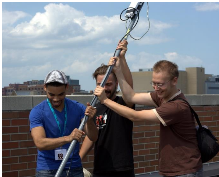
Preston Rhea – Licence CC BY-SA 2.0. Montagem de um roteador (antena) MESH-Wi-Fi instalado sobre o telhado de um bairro de MidTown em Detroit, junho de 2011.
