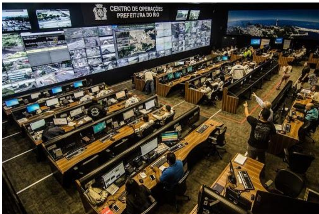
Figura 4 - Sala principal do Centro de Operações do Rio (COR) Fonte: http://cor.rio/institucional/
