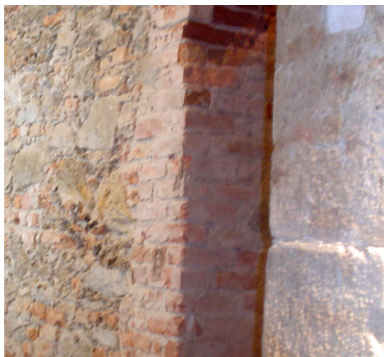
Figura 29. Parede composta por mistura de rochas e tijolos no interior da Igreja da Sé, na rua Primeiro de Março, Centro
