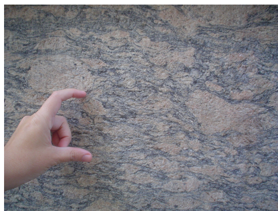
Figura 23. Gnaiss facoidal na fachada do Centro Cultural dos Correios: texturas distintas das cantarias da Igreja da Candelária
