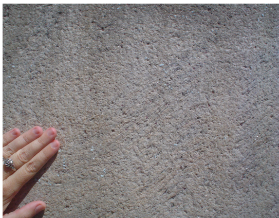
Figura 20. Cantaria de leptinito exposto na fachada da Igreja da Candelária
