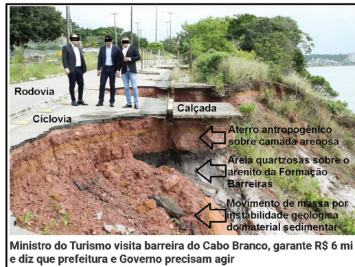
Figura 3. Visita realizada por gestores públicos em ambientes antropizados da falésia. Observar os danos e riscos geológicos presentes na imagem em função de fatores naturais e antrópicos. As cicatrizes expressivas no topo da falésia não foram causadas por abrasão marinha. Fonte: Cardoso (2019)
