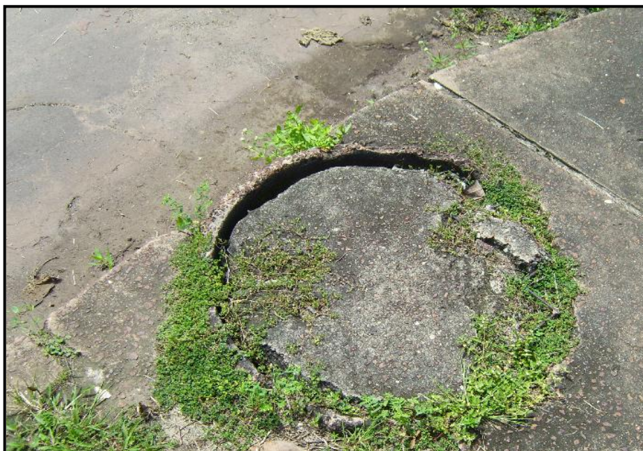
Figura 1.5: Imagem do sistema de esgotamento sanitário em Vila Amazonas Acervo: Jaqueline e Arilena (Agosto/2009)
