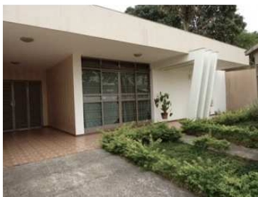
Figura 15: Residência Rua Padre L. dos Santos. Evidencia a distorção do pilar em "V". Fonte: acervo dos autores, 2011.
