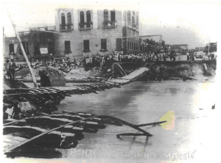
Figura 15 - Consequências para a ponte sobre a nova foz do riacho Maceió após a enchente de 1949.
