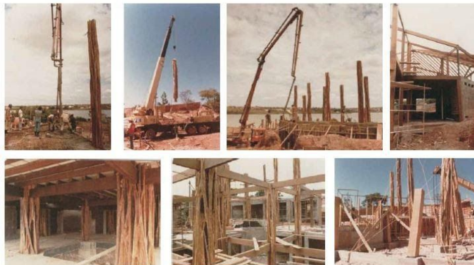
Figura 16: Sequência de fotos da construção da casa, que evidenciam os pilares de Acariquara maciça. Fonte: acervo particular da família Cunha.
